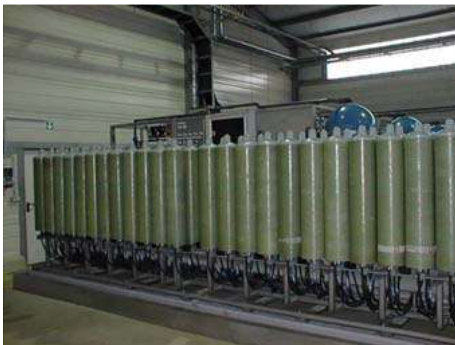
Рис. 4 - Общий вид установки низкого давления с ДТ-модулями (до 65 бар).
