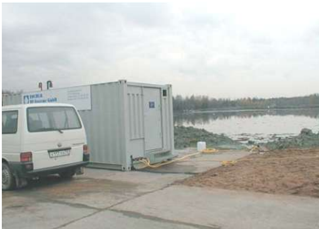
Рис. 2 - Мобильная пилотная установка для очистки сточных вод свалок ТБО. Пилотные установки РОСНЕМ мобильны, абсолютно автономны (требуют только подключения электроэнергии) и могут быть предоставлены организациям в лизинг или с отсрочкой платежа.
