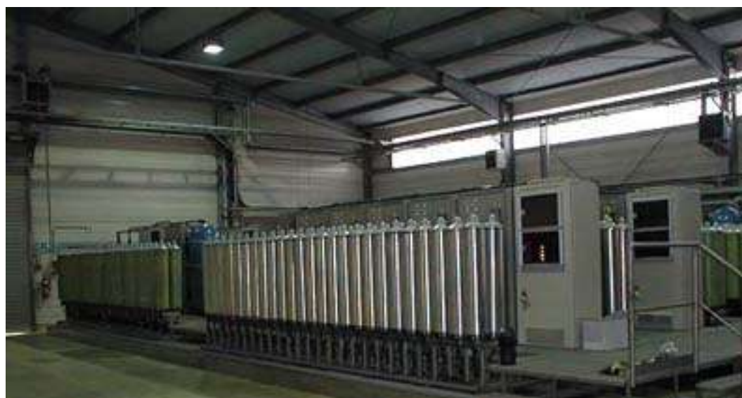
Рис. 5 - Общий вид установки высокого давления с ДТ-модулями (120-200 бар).
