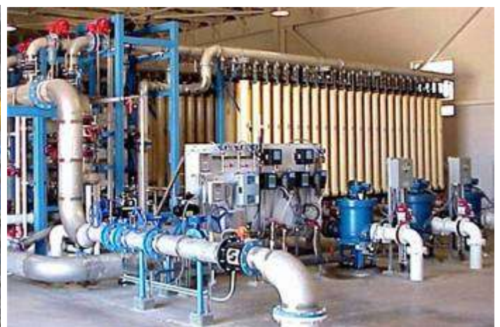
Нетиповая система для очистки 315 м 3 /ч вторичных стоков водопроводной станции (г. Фаунтейн Хилл, США)
