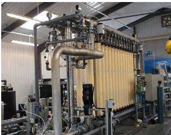
Нетиповая система для очистки 64,5 м 3 /ч вторичных стоков водопроводной станции (г. Питерборо, Великобритания)
